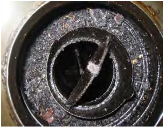
× 防火ダンパー周辺の油汚れ
